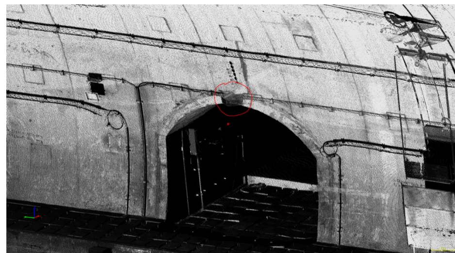
隧道：综合洞室牌子（缺失、损坏、脱落）
