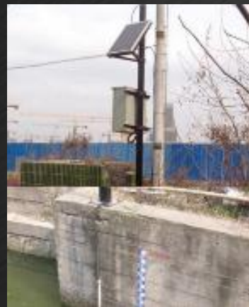
河道水位监测站
